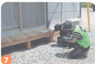
4. 立ち座りのための福祉用具の配備 5. 視覚障がい者用誘導テープ 6. 避難所出入口の段差の解消作業 7. 縁側の高さの評価
